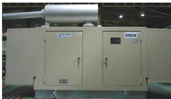
【①非常用発電機】
